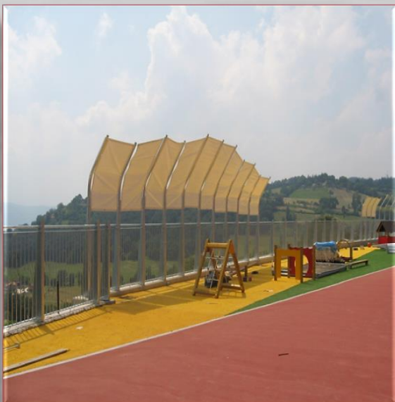
Protezione con pali per sostegno ombreggiatura Eseguita con profili in acciaio S235JR UNI EN 10219 E zincata a caldo a norma UNI EN 1461
